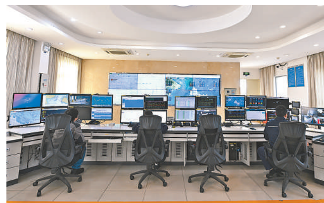
南日岛海上风电场一期项目升压站中控室内景。 本报记者 陈斌摄
