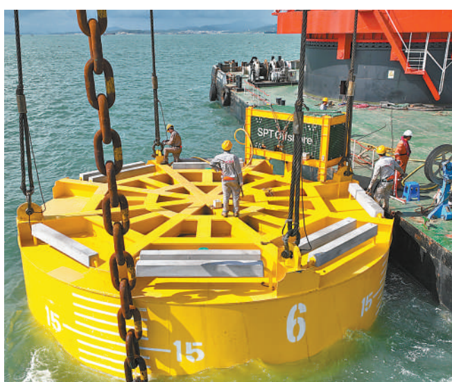
福建莆田南日岛水域，工作人员在向水下放置吸力锚筒。 林启鑫摄
