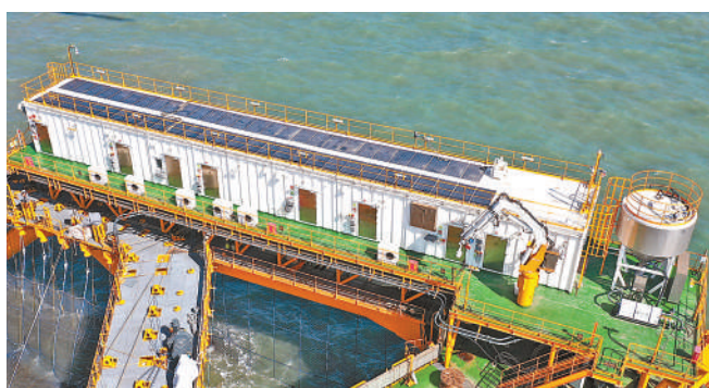
平台上的光伏板和设备间、休息室。 本报记者 陈斌摄
