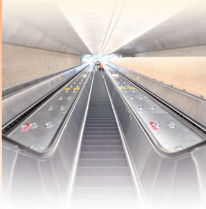
八达岭长城站安装了近百米长的扶梯，垂直高度42米，相当于一幢10多层高的住宅楼。图为八达岭长城站超大扶梯。 本报记者 蒋雨师摄
