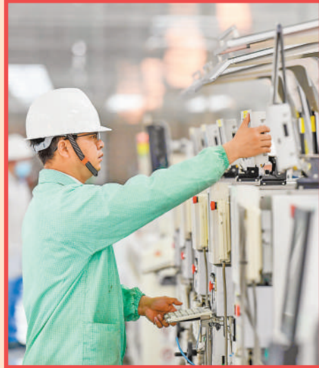
江西丰城市一家外资企业工作人员在新厂房安装设备。 周 亮摄(人民视觉)
