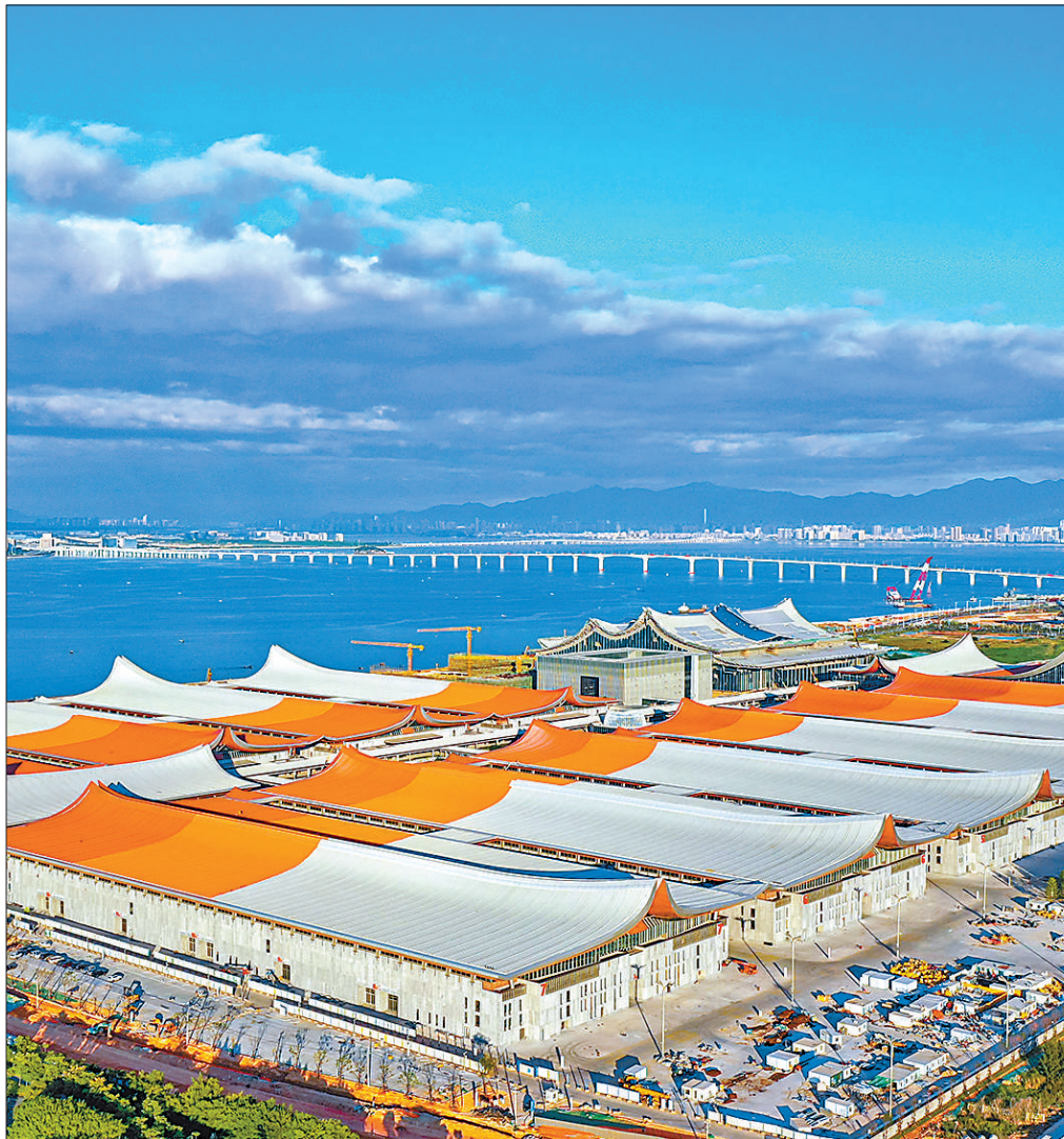
厦门新会展中心—展览中心I标段项目位于福建省厦门市翔安区,总建筑面积约29.78万平方米。据了解,中心投用后能够满足各类展览、活动、演艺等多功能使用要求,也将进一步服务相关产业高质量发展。图为厦门新会展中心—展览中心I标段项目。徐林摄(影像中国)
