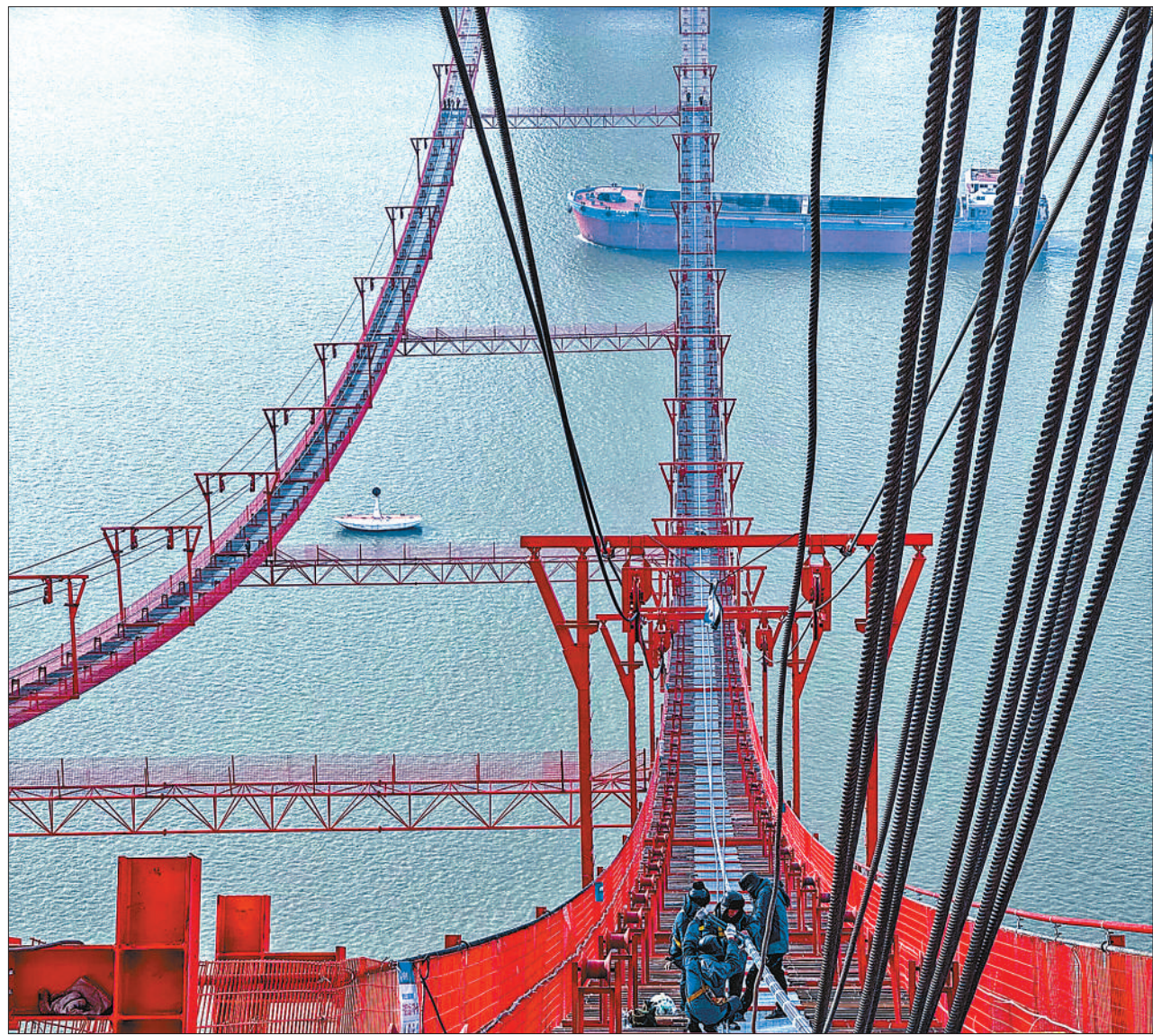
12月4日,G3钢陵长江公铁大桥首根主缆索架完成,大桥正式进入主缆架设施工阶段。G3钢陵长江公铁大桥全长11.88公里,主跨988米。项目建成后,对完善区域综合立体交通网、推动长三角一体化发展和长江经济带高质量发展等具有重要意义。陈磊摄(影像中国)
