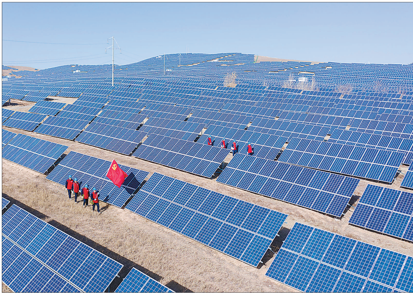
入冬以来，随着供暖、生活等用电需求增加，内蒙古赤峰市进入用电高峰期。为全力保障光伏发电设备安全稳定运行，日前，国网赤峰供电公司组织党员服务队深入林西县十二吐乡苏泗汰光伏发电站检查设备安全运行情况。 丁志军 王英旭摄影报道
