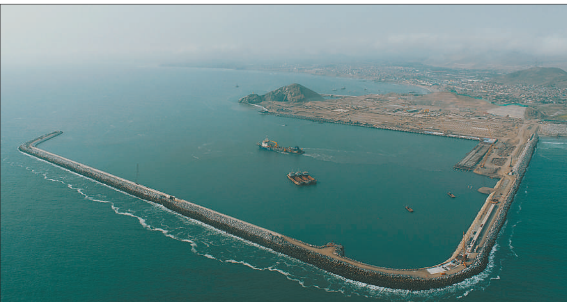
由中国港湾—中交四航局承建的秘鲁钱凯港项目位于秘鲁首都利马以北约60公里，年设计总吞吐量为100万标准箱，建成后将成为南太平洋沿岸重要的交通枢纽和物流中心，极大便利秘鲁的进出口贸易，推动地区发展。图为正在建设中的钱凯港项目主防波堤。 本报记者 宋亦然文 路易斯·阿尔贝托摄
