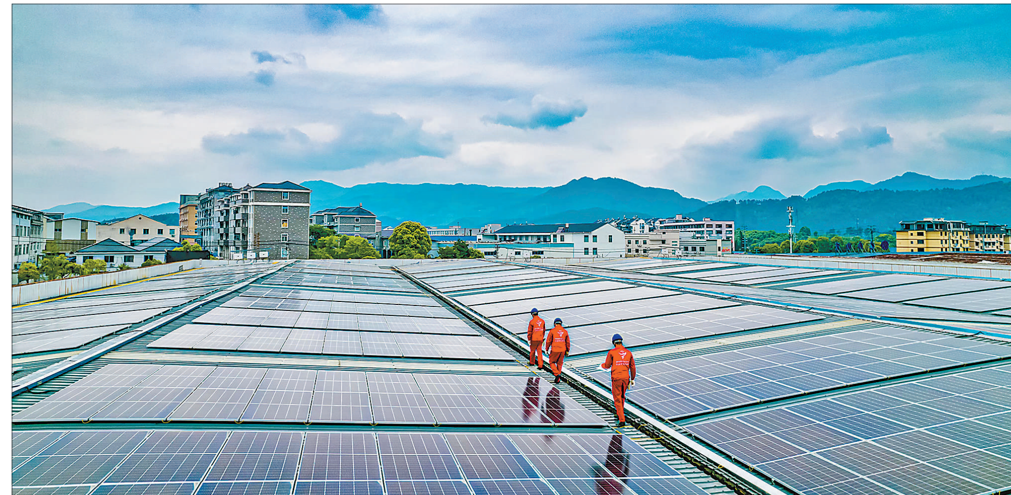
近年来,浙江省丽水市加大清洁能源开发力度,全面推进能源网络建设。据初步统计,丽水境内的技术可开发和利用风能储量在200万千瓦以上,约占全省的50%;光伏发电技术可开发装机容量在400万千瓦以上。国网丽水供电公司以光伏建设运维、储能削峰填谷、市场化售电和设备节能维护为重点,推出“光储售维”四位一体新型能效服务体系,促进当地清洁能源开发利用,助力企业降本增效。图为国网丽水供电公司工作人员在项目现场巡检。
