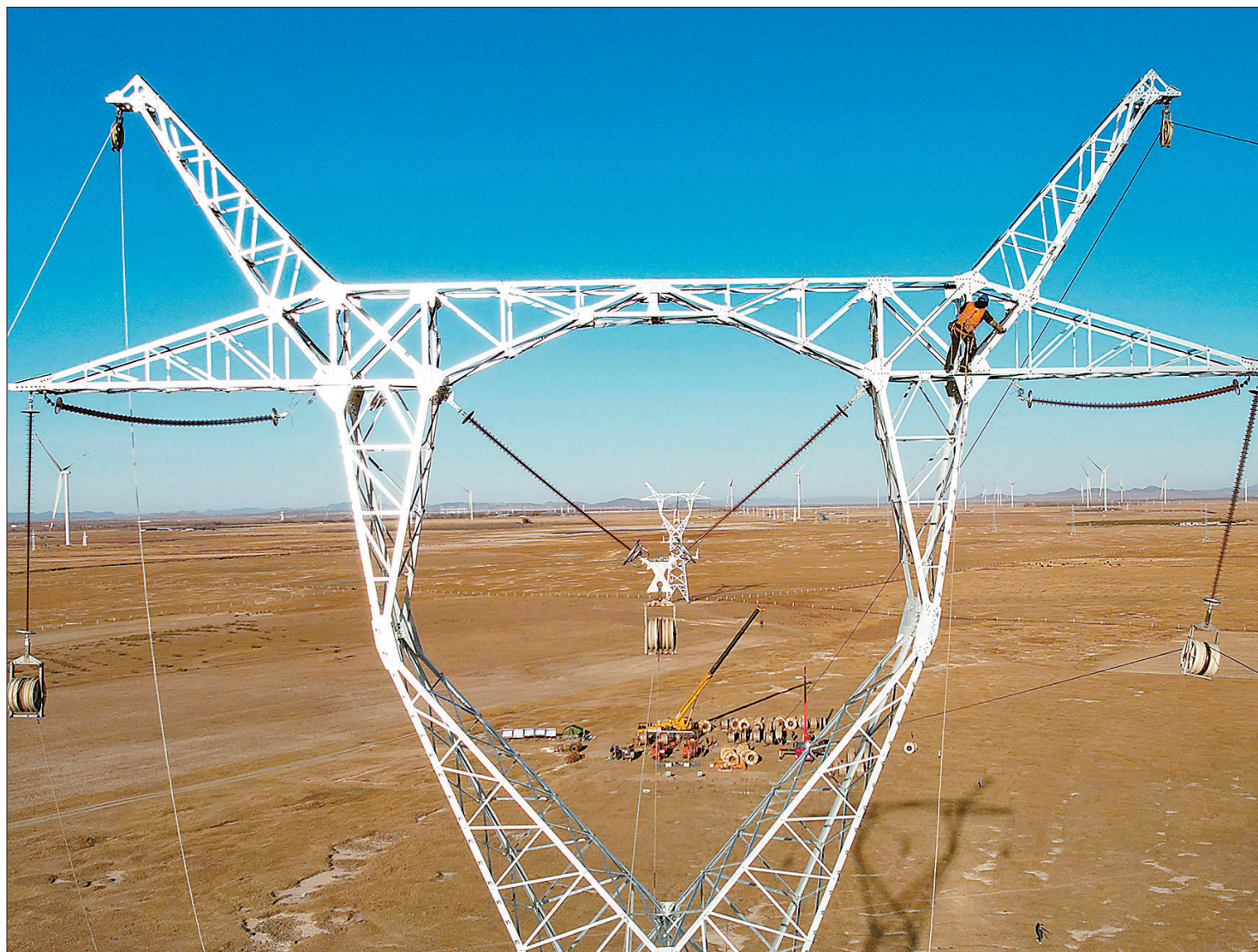
10月30日,工人在内蒙古自治区兴安盟音召500千伏开关站施工现场进行架线作业。据悉,该项目总投资3.6亿元,是内蒙古兴安盟千万千瓦级新能源发电产业集群大型电力配套枢纽工程。
