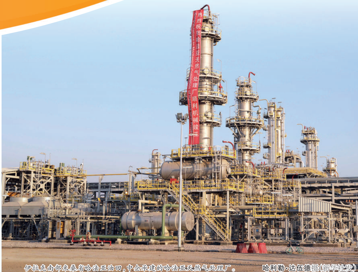
伊拉克南部朱拜勒省哈法亚油田，中企承建的哈法亚天然气处理厂。哈利勒·达伍德摄(新华社发)
