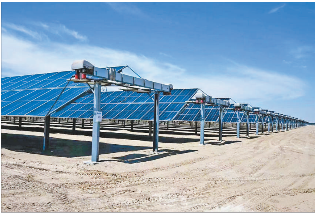
阿联酋艾尔达芙拉PV2太阳能电站项目由国机集团中国机械设备工程股份有限公司承建，是全球最大的单体太阳能电站项目之一。自今年4月并网发电以来，该项目已累计发电29.8亿千瓦时，可满足约16万户当地家庭的用电需求。
