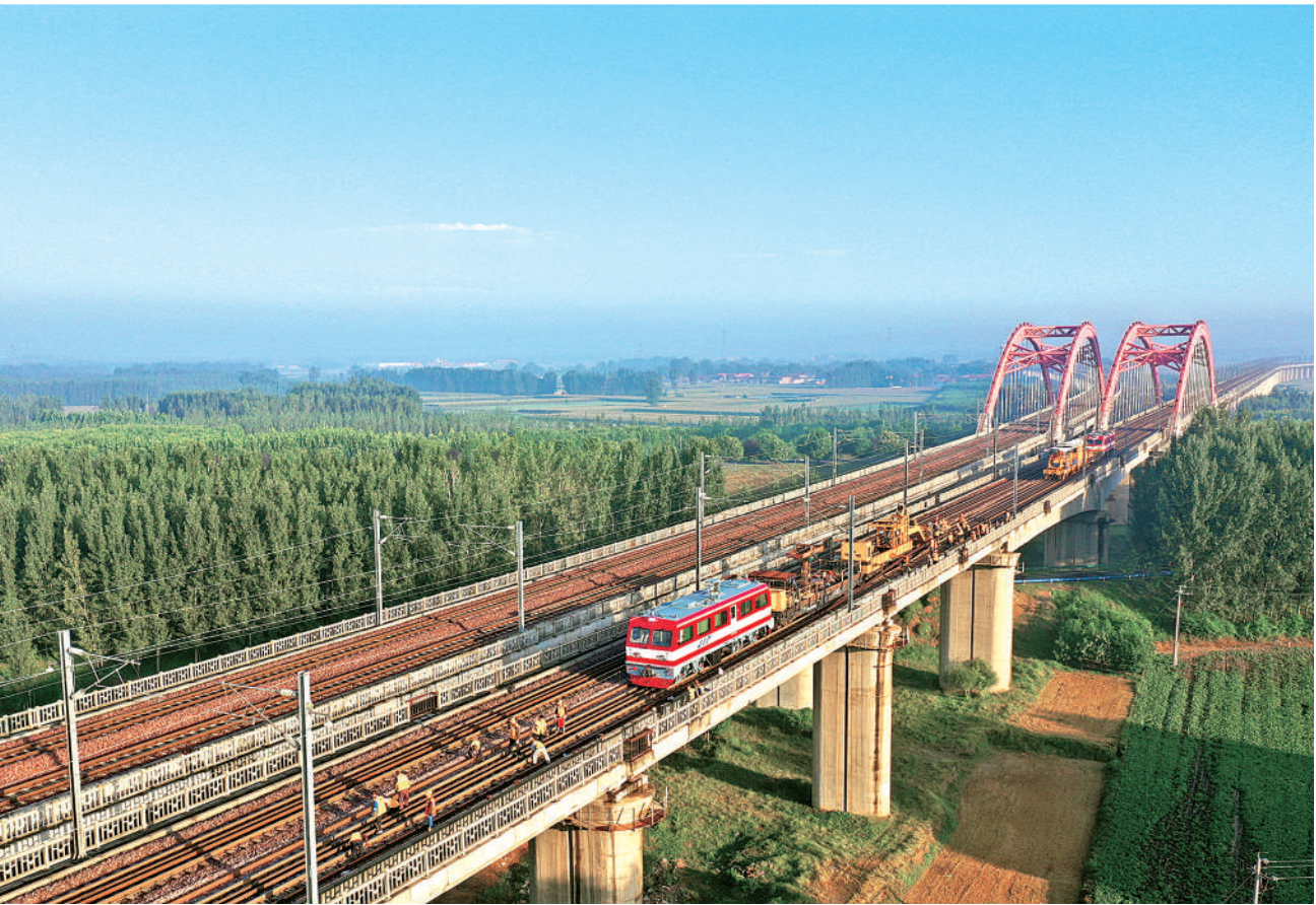
9月20日,河南郑州200余名铁路职工利用大型养路机械车集中更换郑焦城际铁路黄河大桥京广铁路区段的无缝线路钢轨。这是该桥自2014年5月投用以来首次进行换轨施工。据了解,该桥京广铁路区段共计11.28公里的股道到期钢轨将被分段更换,为旅客安全出行提供坚实保障。图为当日换轨施工现场。
