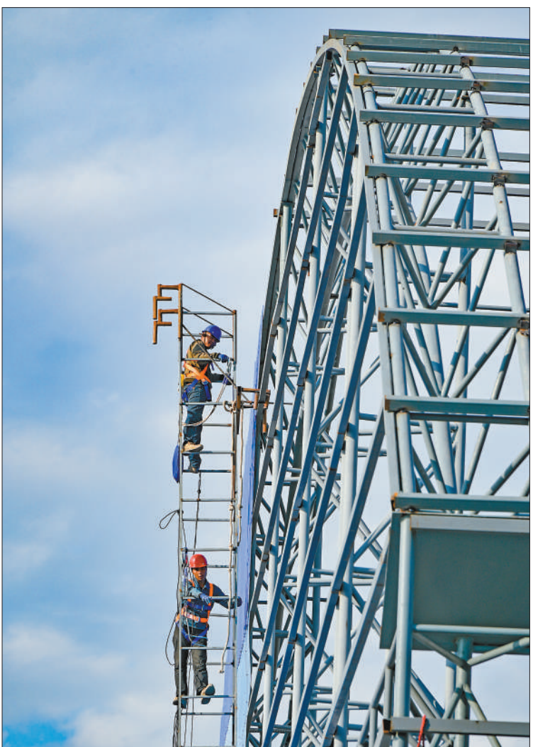
9月16日，新疆维吾尔自治区昌吉回族自治州呼图壁县工业园新材料产业园区的炭化料棚施工现场，工人正在加紧施工。
