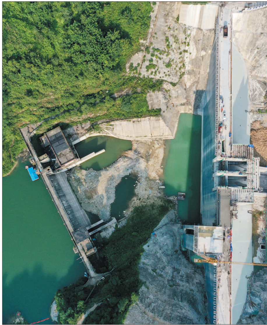
凤山水库位于贵州省黔南布依族苗族自治州福泉市境内重安江上游，是国家172项节水供水重大水利工程之一。图为凤山水库工程施工现场。 易盛武摄(影像中国)
