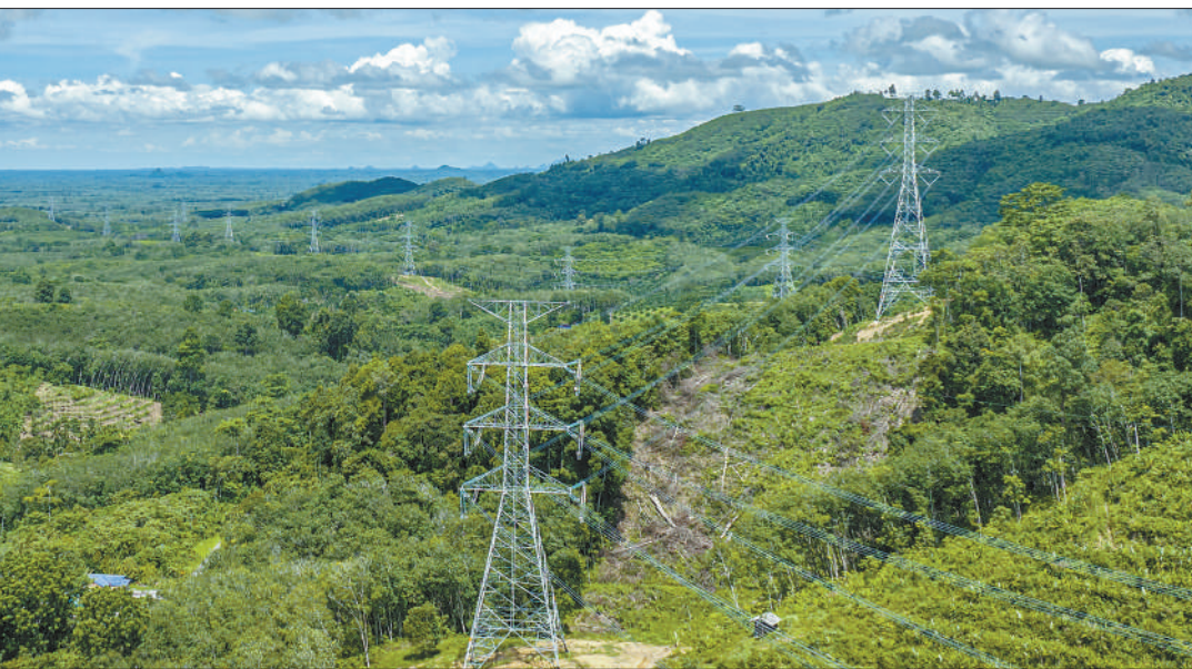
泰国500千伏重缆—宋卡输电线路工程由中国国家电网河南送变电建设有限公司总承包。项目全长105公里，投运后将大幅提升泰国南部地区供电系统安全性、稳定性、可靠性，满足当地日益增长的用电需求，并将有力促进该区域的电力互联互通。
