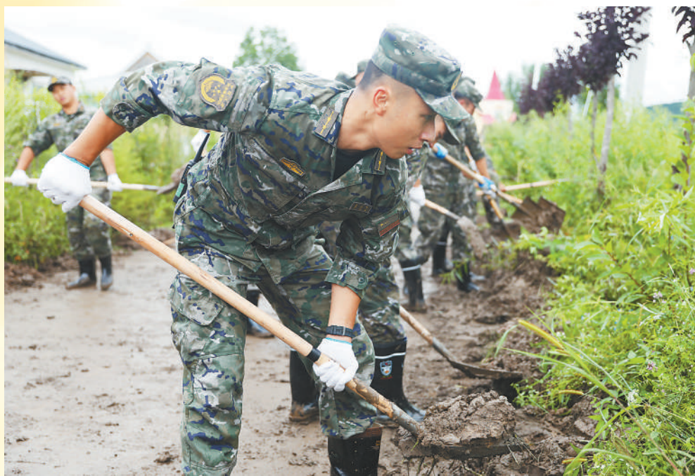
▲日前,武警黑龙江总队牡丹江支队官兵在海林市海林镇清理道路淤泥。刘飞摄(人民视觉)
