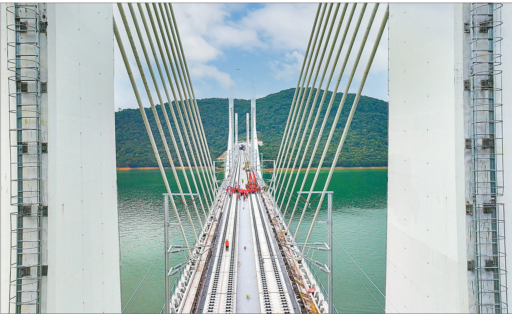
8月21日,安徽黄山,正在铺设钢轨的太平湖特大桥。太平湖特大桥是池(州)黄(山)高铁全线控制性工程,大桥为双柱三塔矮塔斜拉桥,全长926.1米,其中主桥长788米。魏宏祥摄(影像中国)
