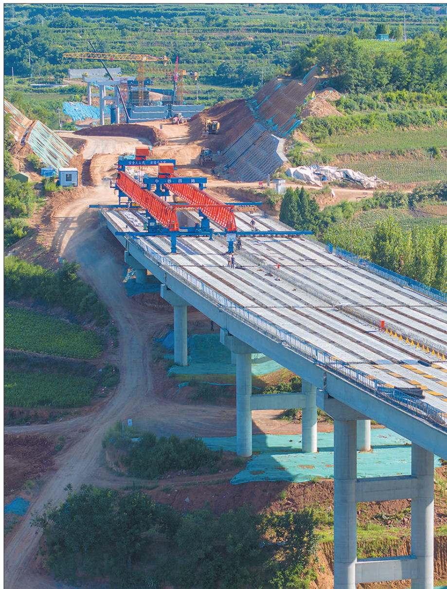
济新高速公路建设项目邵州大桥施工现场,工人正在铺设桥面。李培献摄(影像中国)
