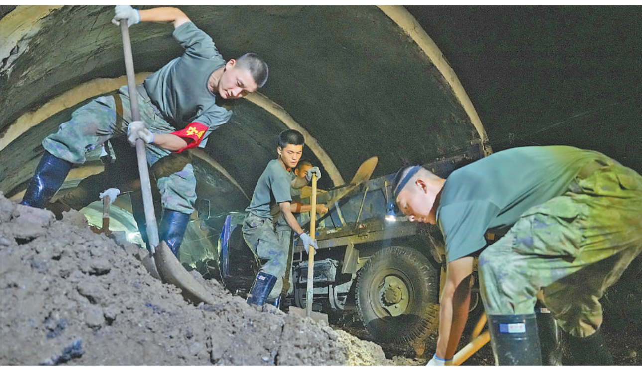
8月12日,在北京市门头沟区雁栖镇,北京卫戍区某部战士清理铁路隧道中的淤泥。
