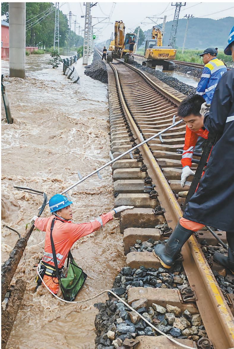
日前,中国铁路哈尔滨局集团有限公司工作人员全力抢修滨绥铁路受淹路段。 栗崧航摄(人民视觉)
