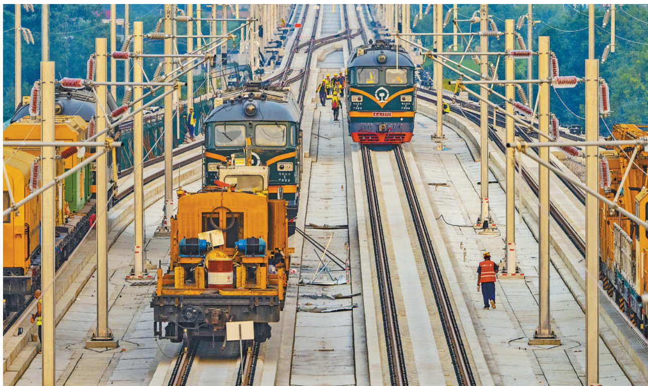
池黄高铁位于安徽省南部山区,线路起自池州站,终止黄山北站,是湖北武汉至浙江杭州高速铁路通道的重要组成部分。全线设池州、九华山、黄山西、黟县东、黄山北5座车站。图为近日,工人在池州市青阳县蓉城镇九华山站进行施工作业。
