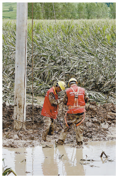
8月7日,国网黑龙江省尚志市供电公司工作人员抢修电路。 王润泽摄(人民视觉)
