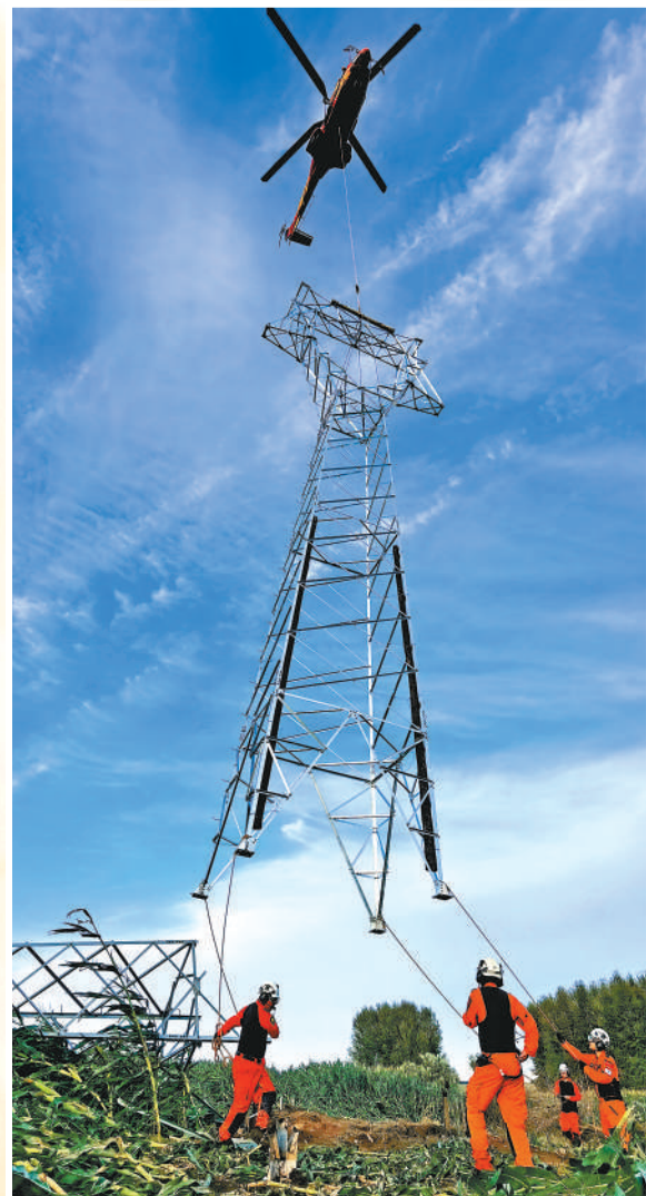
8月9日,国家电网公司调配直升机支援黑龙江电力恢复工作。图为直升机在牡丹江海林110千伏海长线抢修现场整塔吊装作业中。 方圆 张恩全摄影报道
