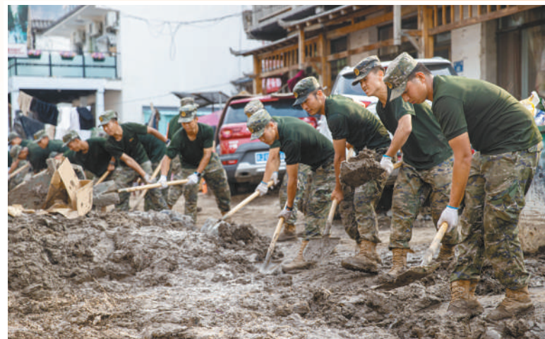
8月8日,武警河北总队保定支队组织突击队河北省涿水县清理淤泥。 本报记者 张武军摄
