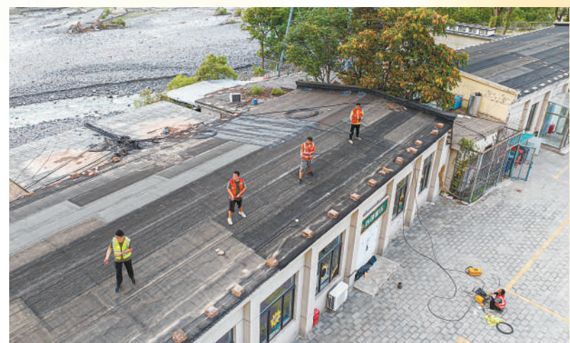
8月5日，中国移动北京公司抢修人员在北京市门头沟区王平镇铺设光缆。本报记者 张武军摄
