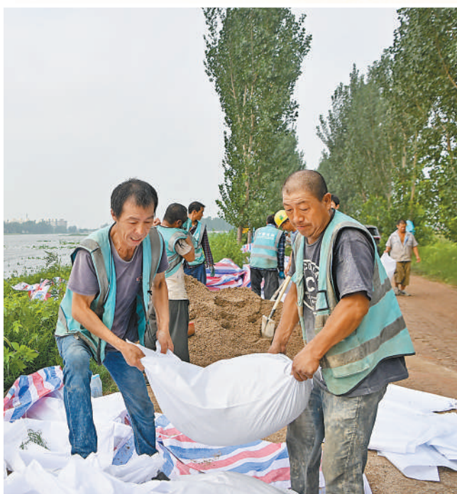
8月3日,天津静海区台头镇,工人在加固堤坝。新华社记者 孙凡越摄
