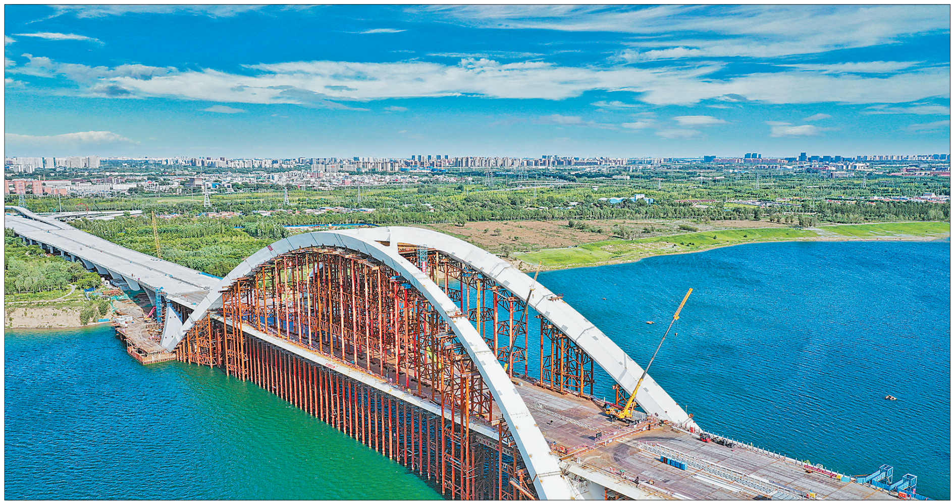
不久前，作为京雄高速公路全线重难点和控制性工程的京雄大桥顺利实现合龙，为实现京雄高速年内全线通车夯实了基础。京雄大桥全长1.62公里，主桥长520米，主拱跨度达300米。该桥建成后，将成为北京单跨跨度最长的桥梁。图为京雄大桥横卧于永定河之上。
