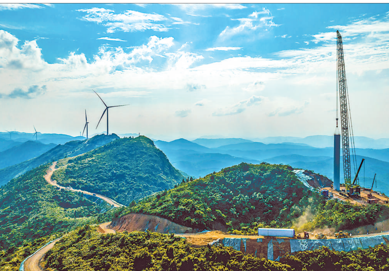
7月11日,江西省瑞昌市横立山风电场项目施工现场,工人正在吊装风电塔筒。近年来,瑞昌市利用丰富的风力资源大力发展绿色清洁能源。魏东升摄(影像中国)
