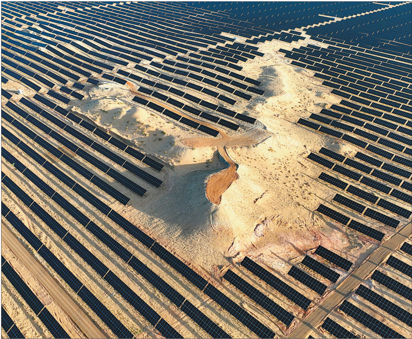
甘肃省张掖市临泽县位于巴丹吉林沙漠南缘，沙漠戈壁占全县总面积的2/3以上。该县在长期坚持生物治沙的同时，积极引入光伏发电治沙项目，昔日的“黄色沙漠”变身“蓝色海洋”。图为7月8日拍摄的临泽县板桥镇北滩沙漠500兆瓦光伏发电治沙项目现场。
