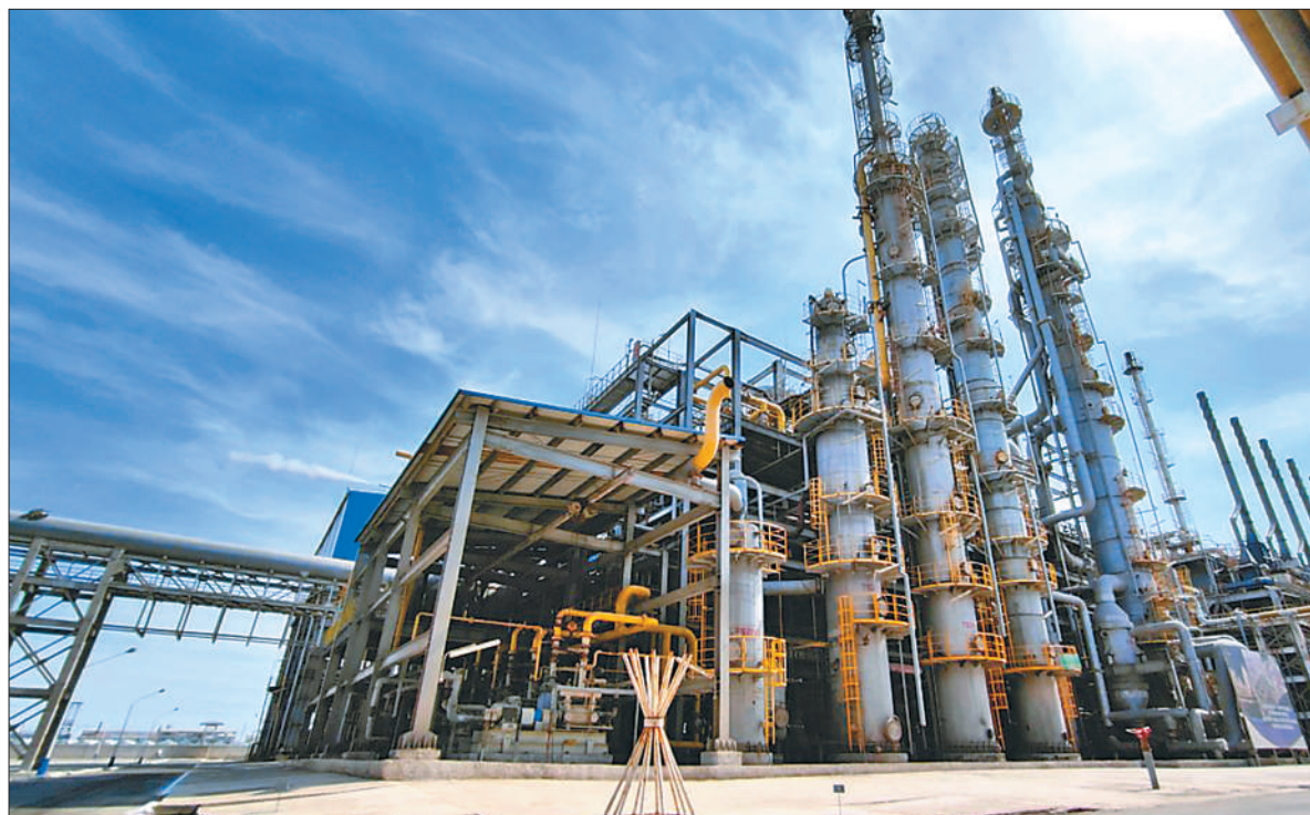
乌兹别克斯坦最大聚氯乙烯生产项目由中工国际工程股份有限公司承建、中国进出口银行提供融资支持。项目自投产以来，改变了乌国内聚氯乙烯、烧碱等产品依赖进口的现状，带动了相关化工产业发展。图为聚氯乙烯生产项目局部设施。 迪里霍特摄
