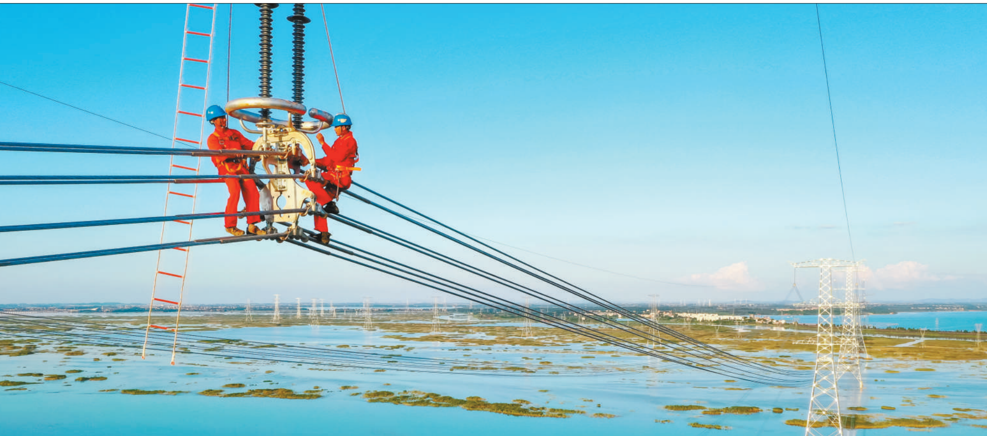
武汉至南昌1000千伏特高压交流线路工程日前在江西进贤县跨越鄱阳湖区展放导线。武南线特高压交流工程是华中电网整体规划的重要组成部分,建成后,华中地区将形成“日”字形特高压主网架,有助于进一步加强华中地区电力互联互通,消纳西南水电和西北风光等能源,优化能源结构,为赣鄂两省提供清洁绿色能源。
