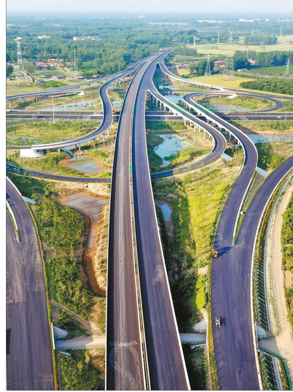
江苏省宿迁市沭阳县十字街道境内，在建的连宿高速公路工程与G2京沪高速扩建工程交会，十分壮观。据了解，连宿高速公路预计年底建成投入使用。
