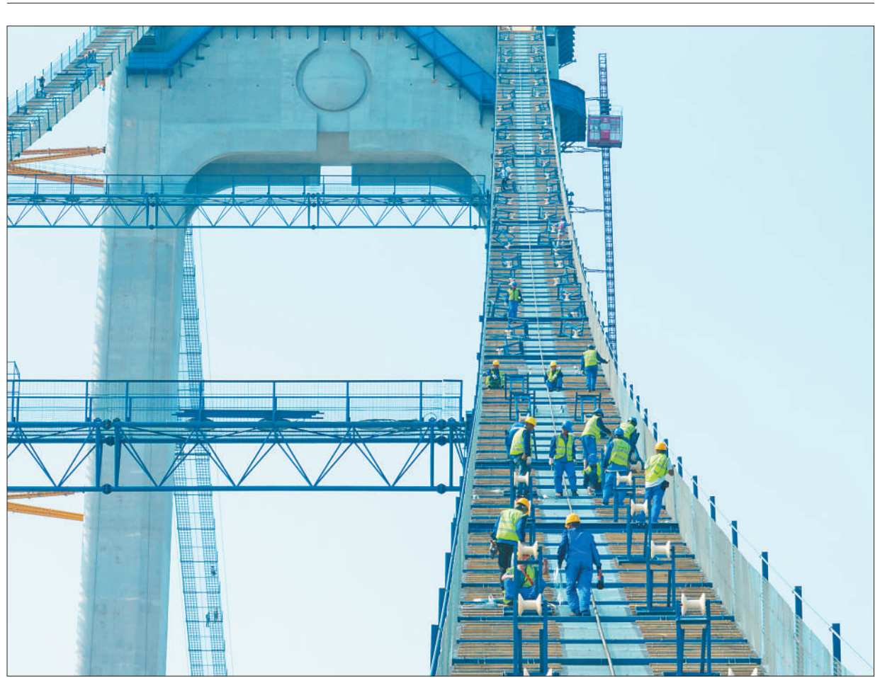
6月12日,江苏省龙潭长江大桥南北主塔之间的猫道架设顺利完成。据了解,龙潭长江大桥单幅猫道宽4米,单侧猫道承重由10根54毫米粗的钢丝绳构成,长度达2818米。龙潭长江大桥北接扬州市仪征市,南接南京市、镇江句容市,双向六车道,设计时速100公里,全长约5公里。方东旭摄(影像中国)
