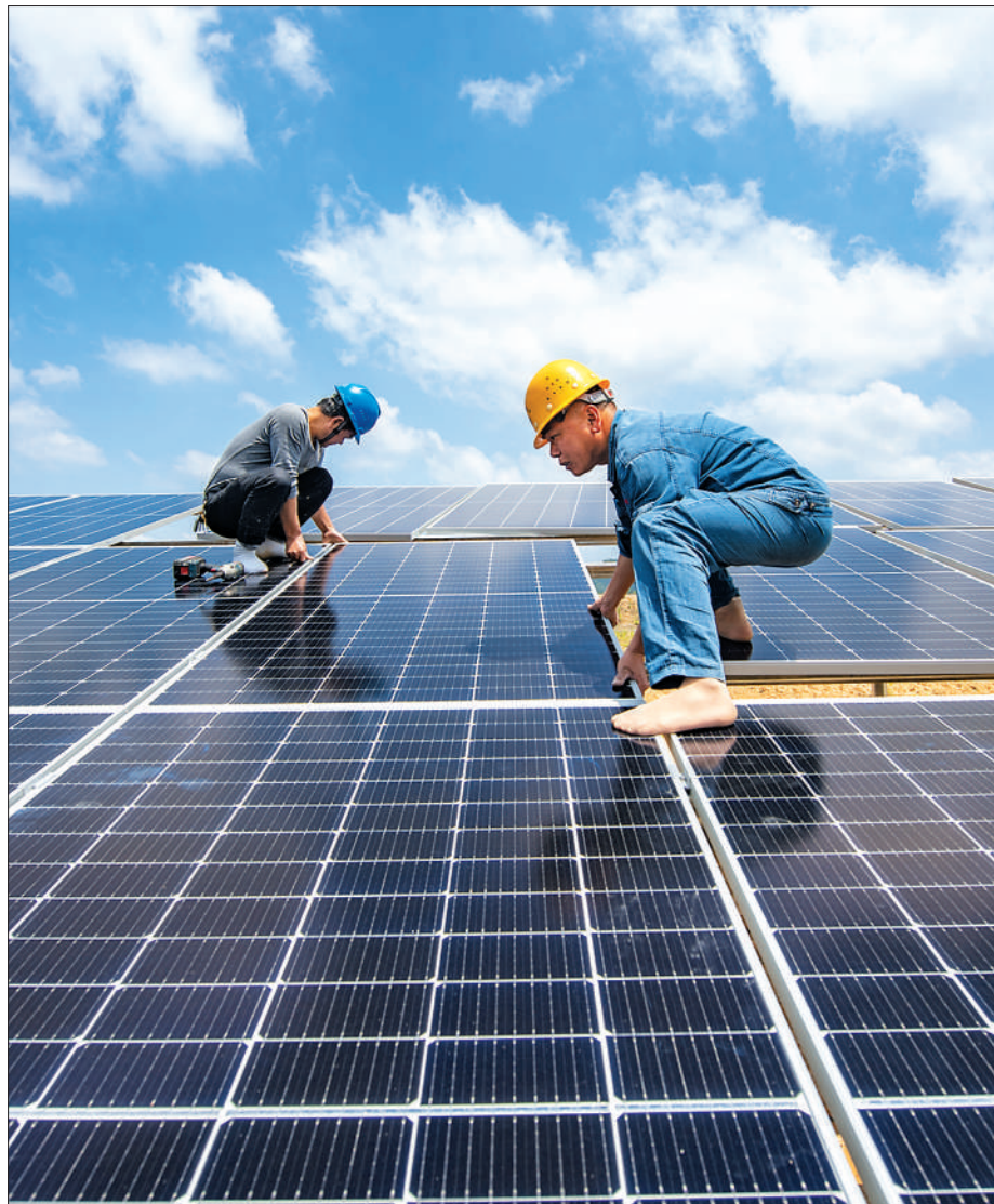
江西省新余市仰江村原矿厂遗址一个光伏电站建设现场，工人在安装太阳能电池组件。
