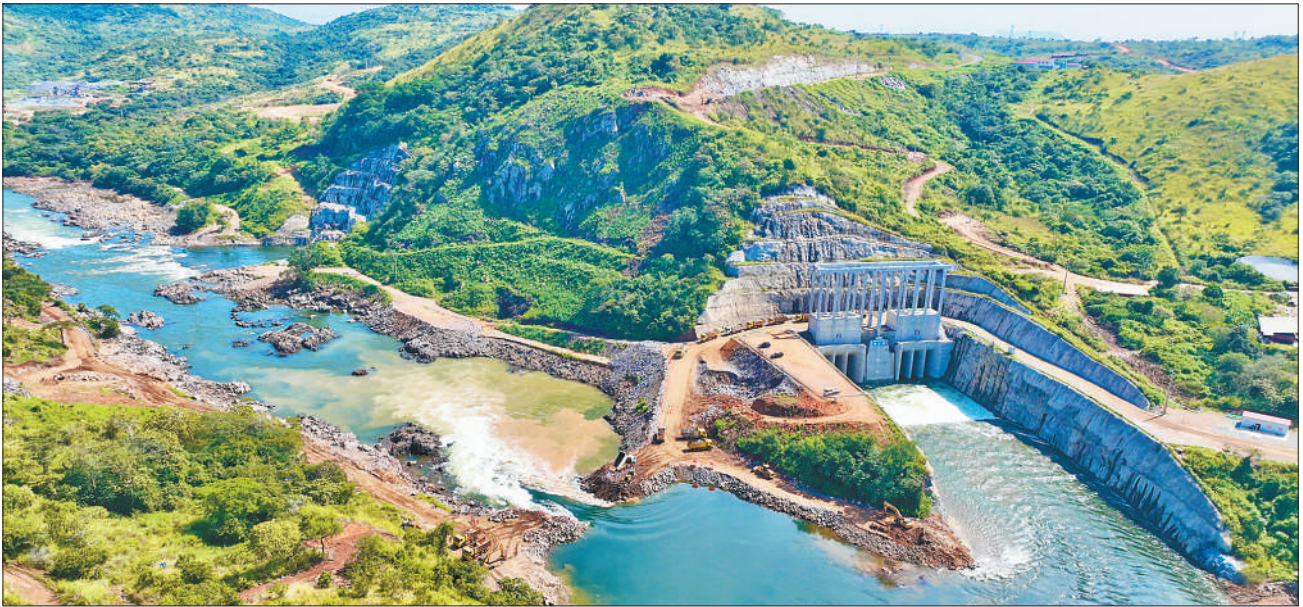
由中国能建葛洲坝集团承建的安哥拉凯凯水电站日前截流成功，标志着水电站进入大坝主体工程施工阶段。凯凯水电站是安哥拉的国家重点项目，建成后，年平均发电量将达到8566吉瓦时，每年减少温室气体排放量约720万吨，兼具调峰防洪功能，助力当地经济社会发展。张春特摄
