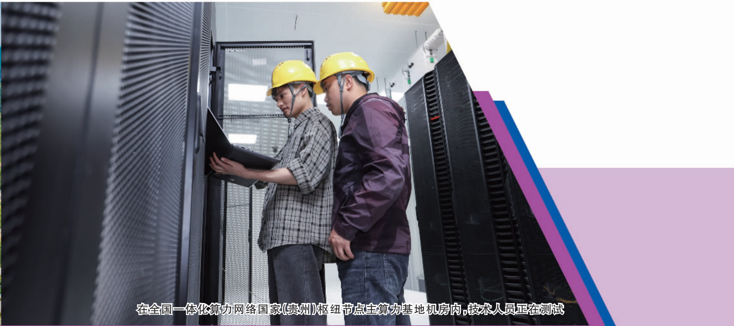
贵安腾讯七星湖数据中心
