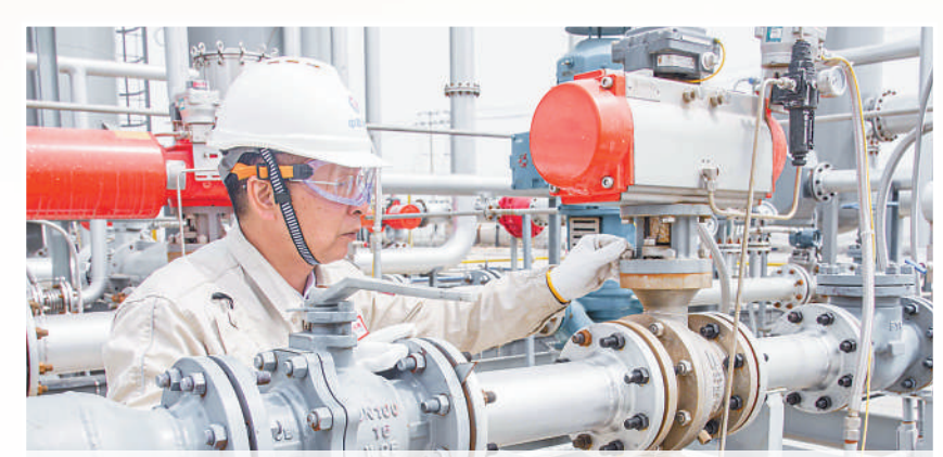
安全监督 高东斌 全国劳动模范、中海油惠州石化有限公司运行七部生产安全监督高东斌在检查确认现场设备运行情况。2015年至今，高东斌参与处理18个装置隐患，避免装置非计划停工8次，为企业除隐患增效益。 湛小翠摄(人民视觉)
