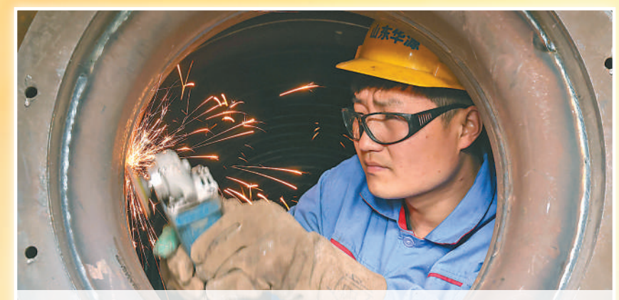
焊接能手 齐玉祥 全国劳动模范、山东省华源锅炉有限公司焊接车间焊工齐玉祥对炉膛内壁进行打磨作业。他结合工作创新技术，每年为企业节约费用百万余元。 许传宝摄(人民视觉)
