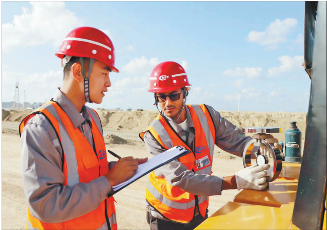
阿布基尔集装箱码头项目位于埃及第二大城市亚历山大以东30公里的阿布基尔港内，整体工程由疏浚吹填、码头、护岸、防波堤、道路、堆场、水管管、房建以及相关配套设施组成，由中国港湾工程有限责任公司总承包。目前，项目建设稳步推进，预计可为当地提供约2000个就业岗位，一些当地毕业的大学生也积极应聘上岗，投身项目建设中。 上图：阿布基尔集装箱码头项目远景。 左图：刚大学毕业的埃及小伙阿卜杜拉(右)跟着中国同事学习级配碎石质量检测。 史筱迪摄影报道
