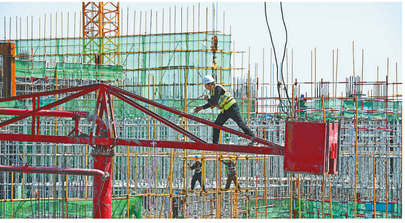
4月30日,北京市海淀区西北旺镇的海淀大悦城项目工地,工人坚守岗位、抓紧施工。项目计划5月中旬完成主楼封顶。本报记者 雷声摄
