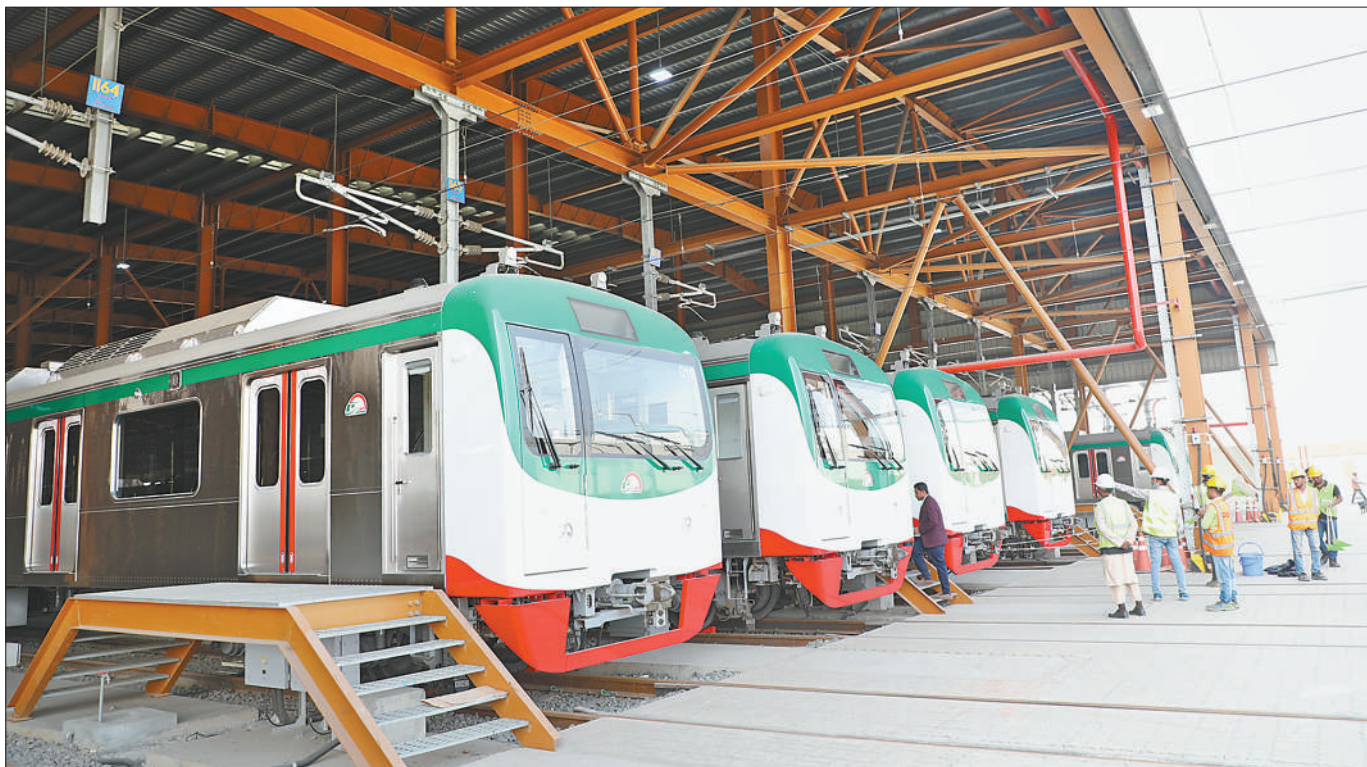
去年底,孟加拉国首都达卡的城市轻轨6号线正式通车,这条中企参与建设的轻轨极大改善了达卡城市交通状况。图为日前,达卡城市轻轨6号线列车在运营中心停车场内进行保养、检修。
