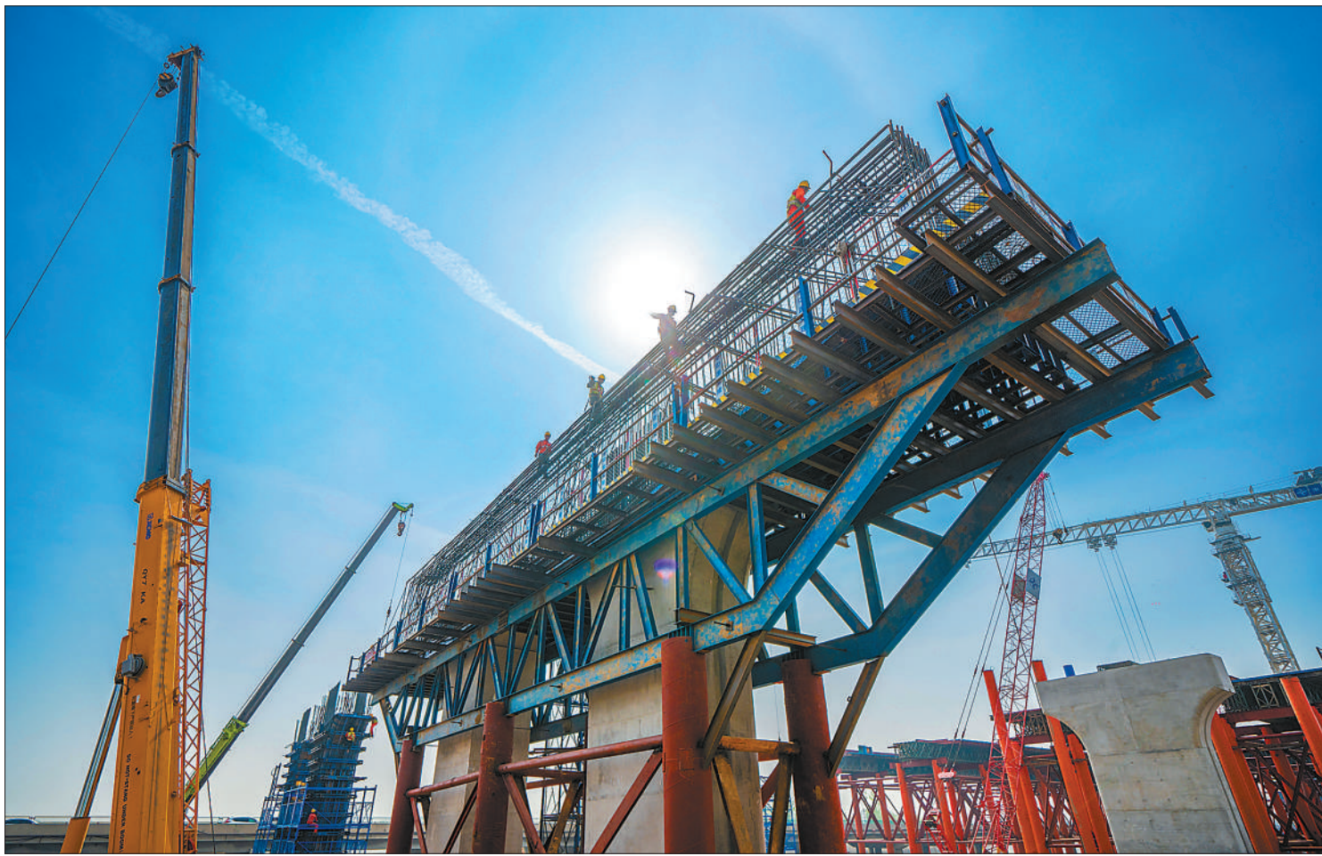
近日,在河北省正定县复兴大街改造项目滹沱河特大桥建设工地,工程人员连续奋战,加紧施工。复兴大街改造项目完成后将成为城区道路主动脉,方便群众出行。图为大桥施工现场。(武志伟摄(影像中国))
