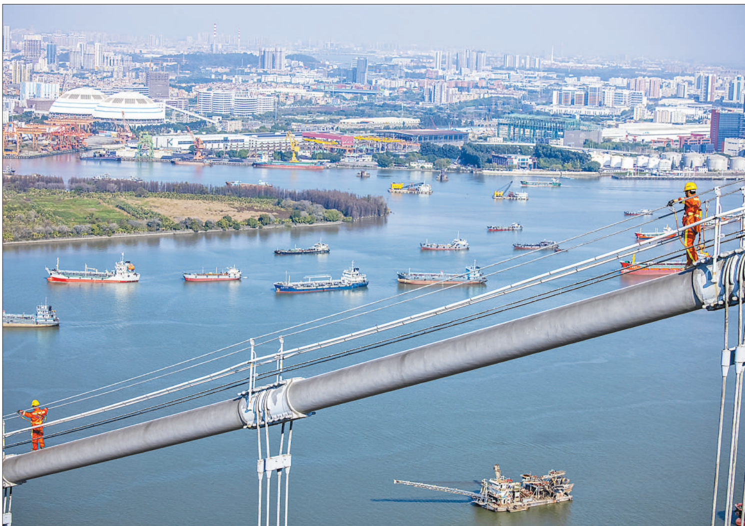
2月20日，广东省广州市，工作人员正在对黄埔大桥悬索桥主缆进行检修工作，确保桥体缆索结构安全。该桥全长7016.5米，北起黄埔区萝岗街道火村立交、接京港澳高速公路，上跨珠江及其大吉沙岛，南至番禺区化龙镇化龙立交、接广澳高速公路，是广东省特大型桥梁与隧道建设的重大成果。
