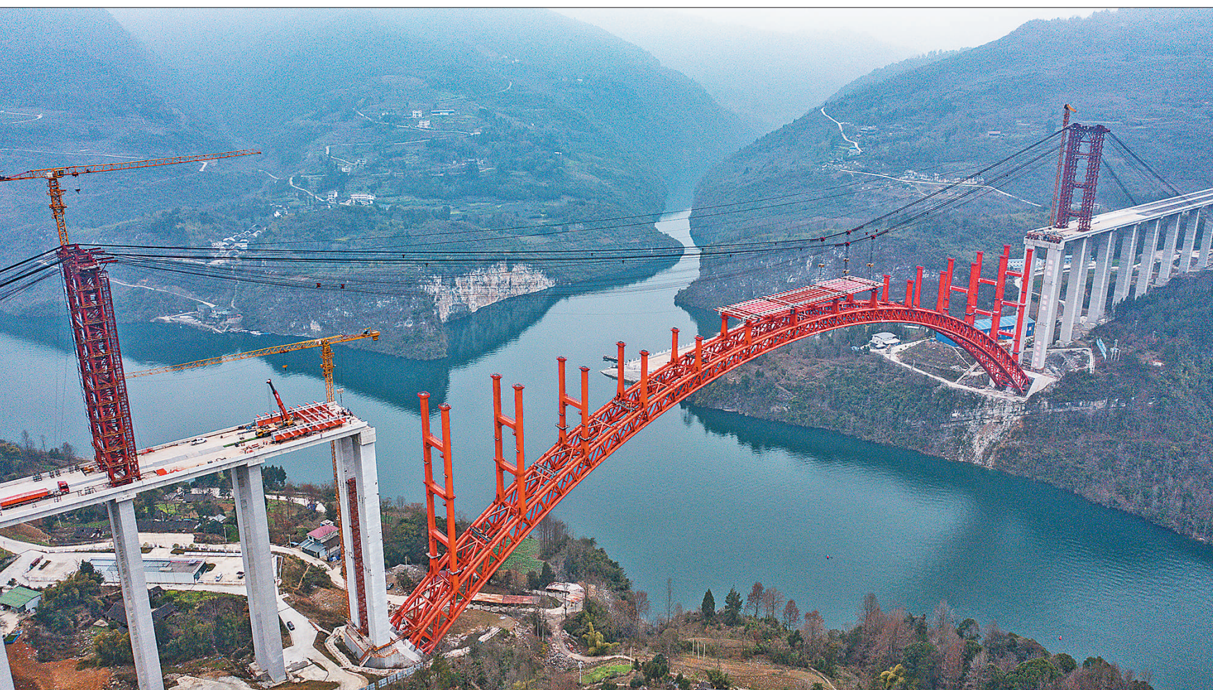
德(江)余(庆)高速乌江特大桥位于贵州省思南、石阡、凤冈三县交界处,大桥全长 1834 米,主跨 504 米。目前,大桥进入桥面系施工阶段。大桥与高速建成通车后,将完善当地路网结构,助力经济高质量发展。 图为 2 月 17 日,大桥正在进行桥面系施工。
