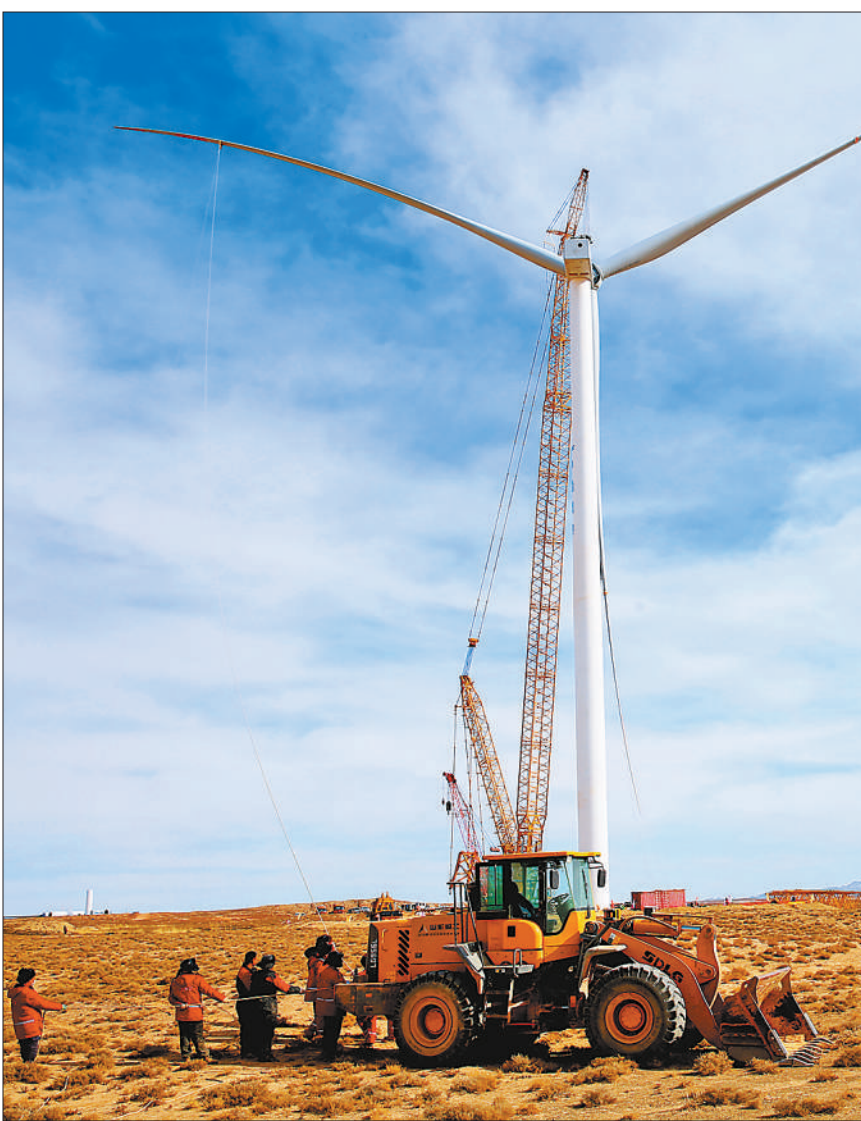
甘肃省张掖市近年来大力发展风电产业,推动经济高质量发展。图为2月10日,建设人员在张掖市甘州区平山湖30万千瓦风电场进行风机吊装作业。
