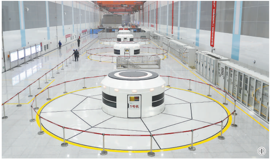
图①:丰宁抽水蓄能电站部分机组。
