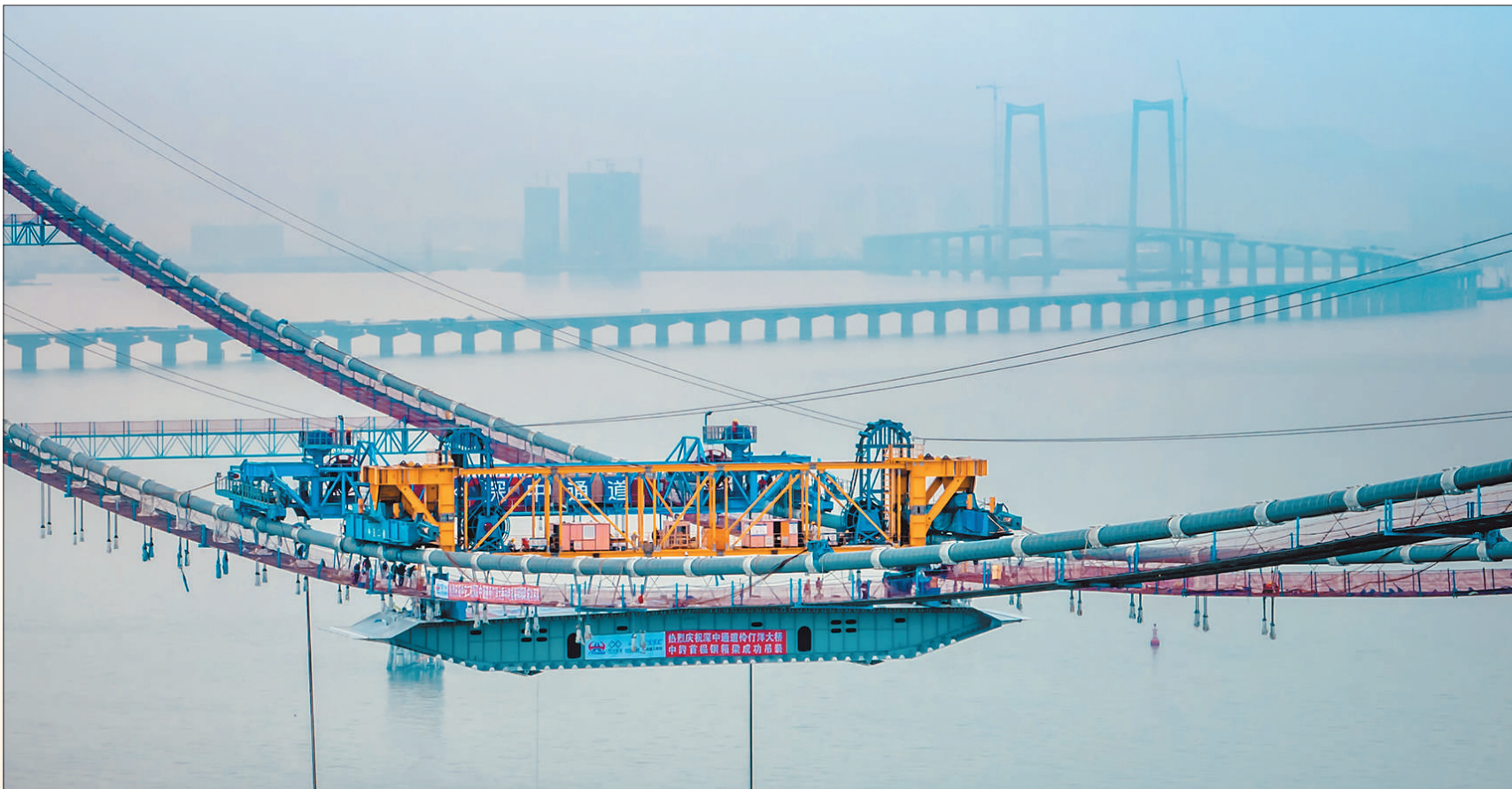
1月12日,深中通道伶仃洋大桥首根箱梁成功吊装,大桥建设再次取得突破性进展。深中通道预计2024年实现通车,届时从广东省深圳市到中山市的车程将由原来的2小时缩减至20分钟。作为深中通道关键控制性工程之一,伶仃洋大桥为主跨1666米的三跨全漂浮体系悬索桥,主塔高270米,是世界最大跨径海中钢箱梁悬索桥、最高海中大桥,共有213根钢箱梁,钢结构用钢量约9.77万吨。 程远州 苏振飞摄影报道
