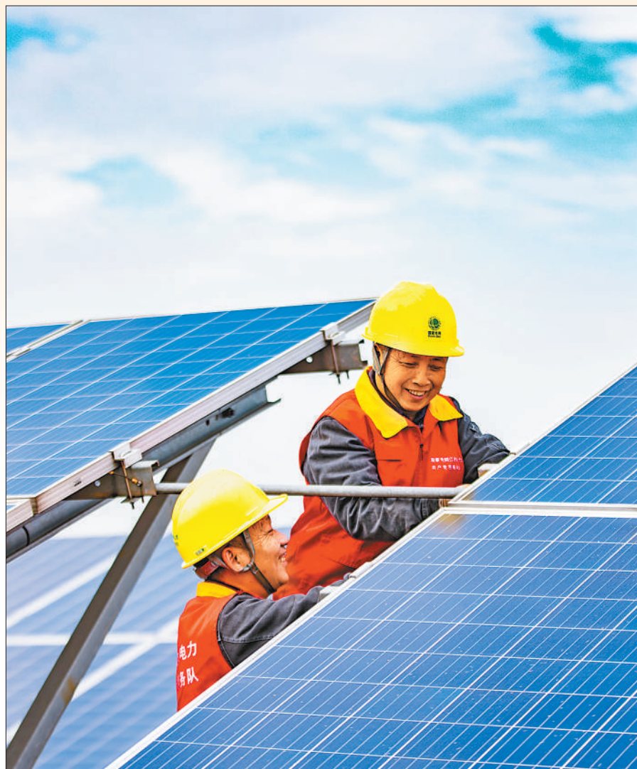
1月11日,江西省弋阳县南岩街道3.6兆瓦光伏发电基地,供电工作人员对光伏发电设备进行全面维护和检修,确保春节期间稳定发电,满足群众用电需求。 黄祥龙摄(人民视觉)
