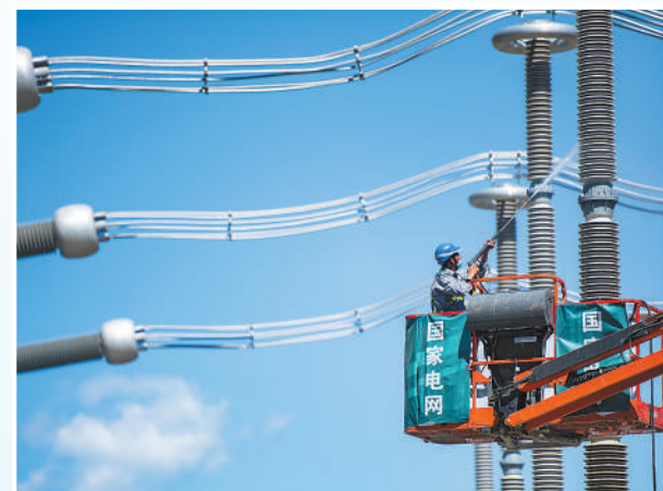
北京市延庆区八达岭镇里地村,检修工人在张北柔性直流电网延庆换流站清洗绝缘立柱。 郑贤列摄(影像中国)
