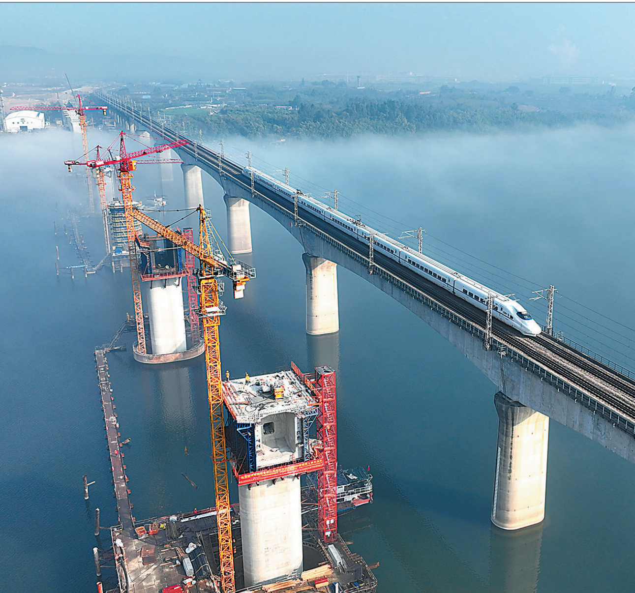
1月10日，广西柳州柳江上空云雾缭绕，正在建设的湘桂线柳江双线特大桥梁，一列动车组列车从铁路线上驶过。柳江双线特大桥梁为湘桂铁路柳州枢纽扩能改造工程的重点控制工程。黎寒池摄(影像中国)
