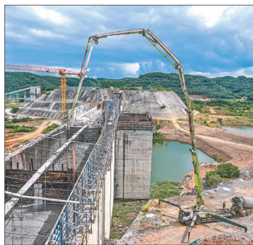
海南省儋州市,天角潭水利枢纽工程主坝正进行混凝土浇筑施工。
