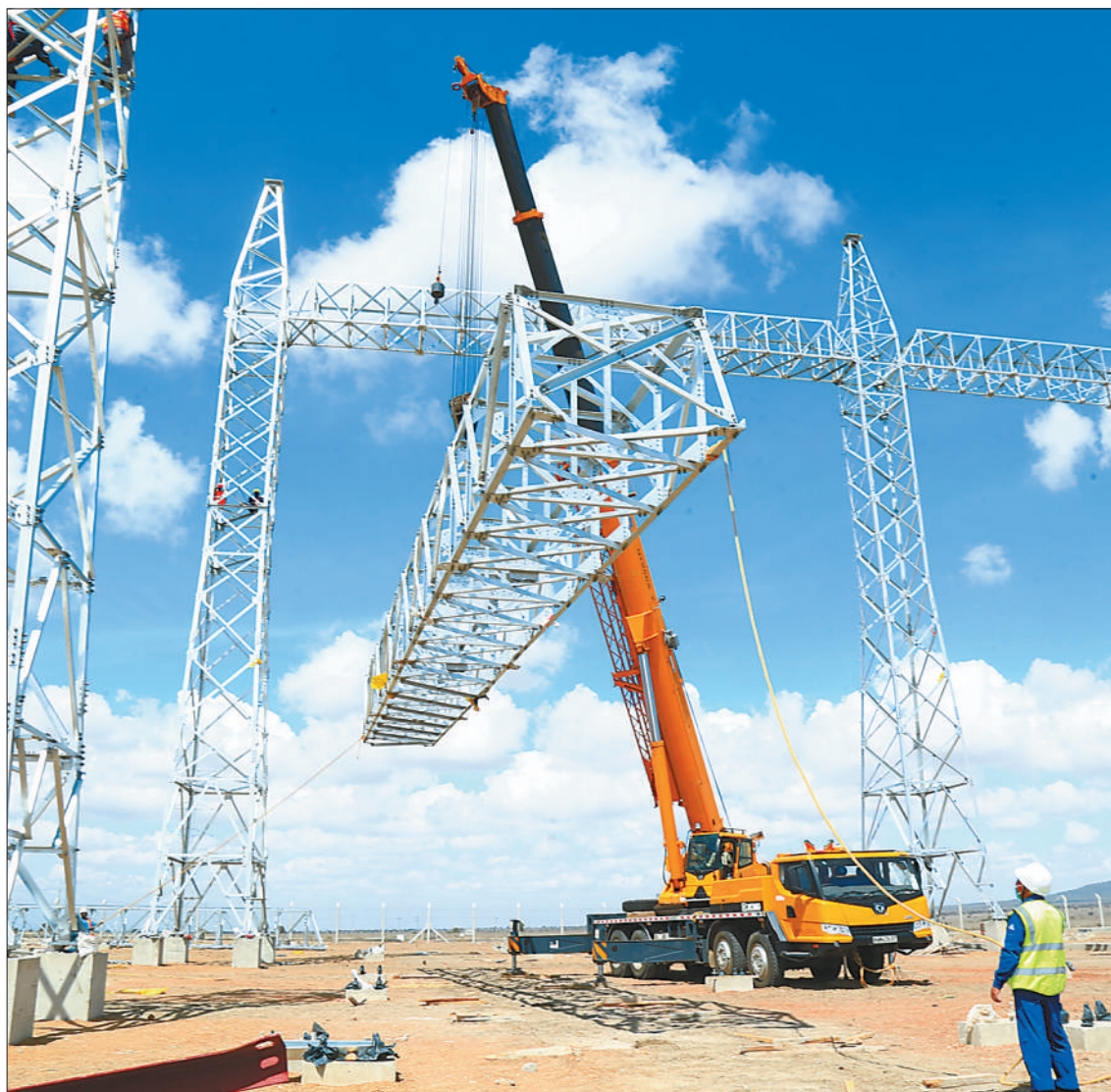
由中国航天建设集团有限公司承建的肯尼亚电力传输扩建项目位于肯尼亚孔扎科技城内,是中共共建“一带一路”重要项目,也是肯政府“2030愿景”旗舰项目之一。项目建成后,将为孔扎科技城及其周边地区数万居民和学校等保障电力供应。图为施工方近日在进行400千伏变电站构架吊装作业。
